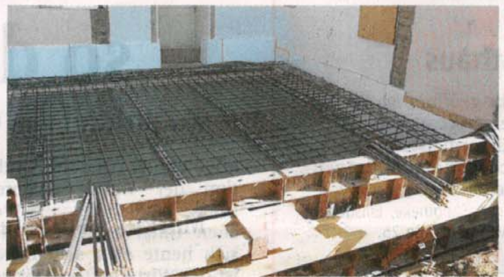
Es ist ein Fundament für ein neues Leben, was nun endlich gegossen werden konnte.
