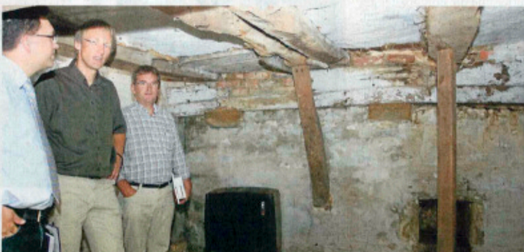
Im Keller sieht man an den Holzbalken, dass hier der bunt gescheckte Nagekäfer erhebliche Schäden angerichtet hat. Wie man diesen Schädling beseitigt, ist noch unklar.
